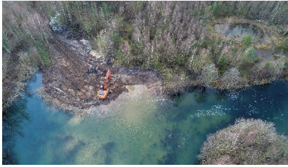
Ein Bagger gräbt eine Flachwasserzone in einen sonst steil abfallenden Baggersee. Diese wird später zur erfolgreichen Kinderstube für Jungfische. ©Thomas Klefoth
